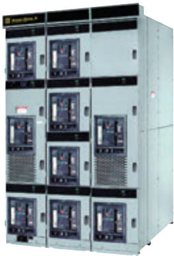
PZ4 Vista frontal compartimentos de interruptores
