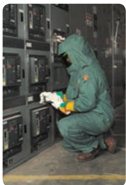
Equipo de Protección Personal, Nivel 4, determinado con estudio de Arc Flash.
