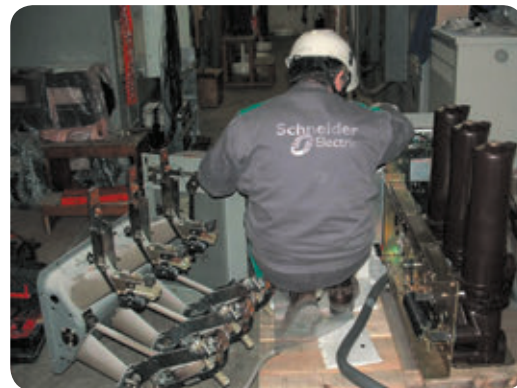
ECOFIT de un interruptor en MT.
