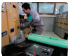
ProFusion, Diagnóstico del funcionamiento de fusibles de MT
